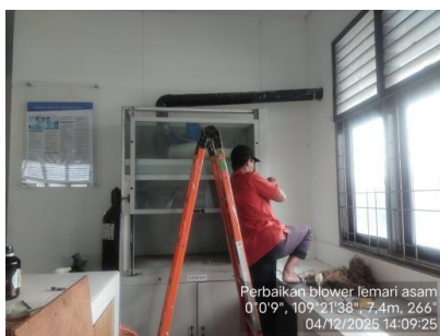
Gambar 27. Penggantian blower pada lemari asam yang mengalami korosi
